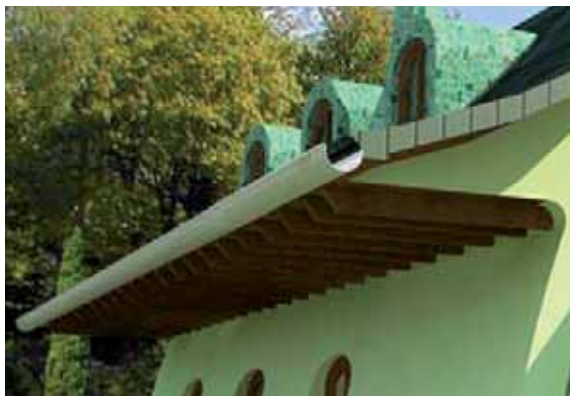
Recogida de aguas pluviales mediante canales.
