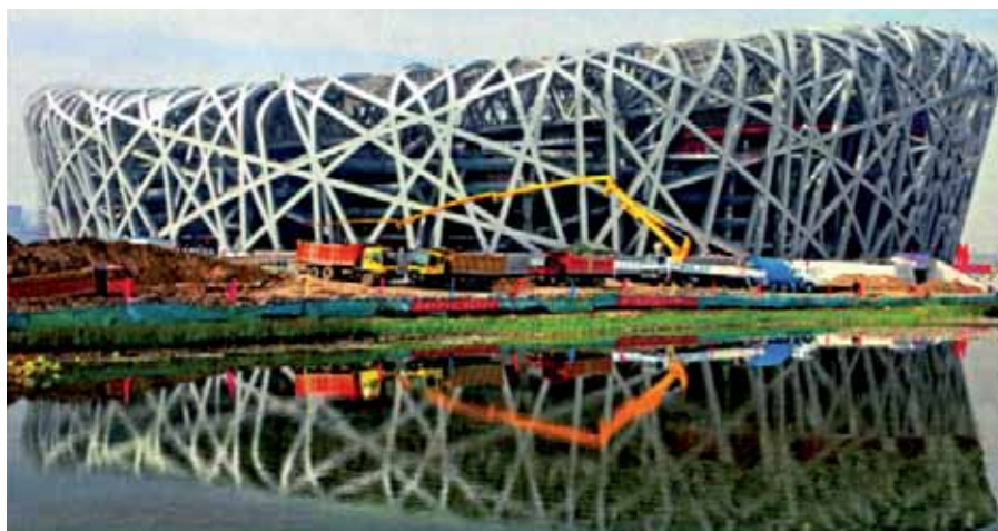
El estadio Nacional de Pekín, 2008. El simbolismo es un nido de pájaros, apropiado a la mentalidad china. Una estructura muy sólida, de hormigón armado y 45.000 Tn de tubos de acero representan las pajas del nido. La estructura, bien visible, envuelve a los espectadores. Coste: 325 millones de euros.
